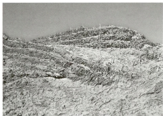
图七 LE 古城东墙内外墙体错位坍塌情况
